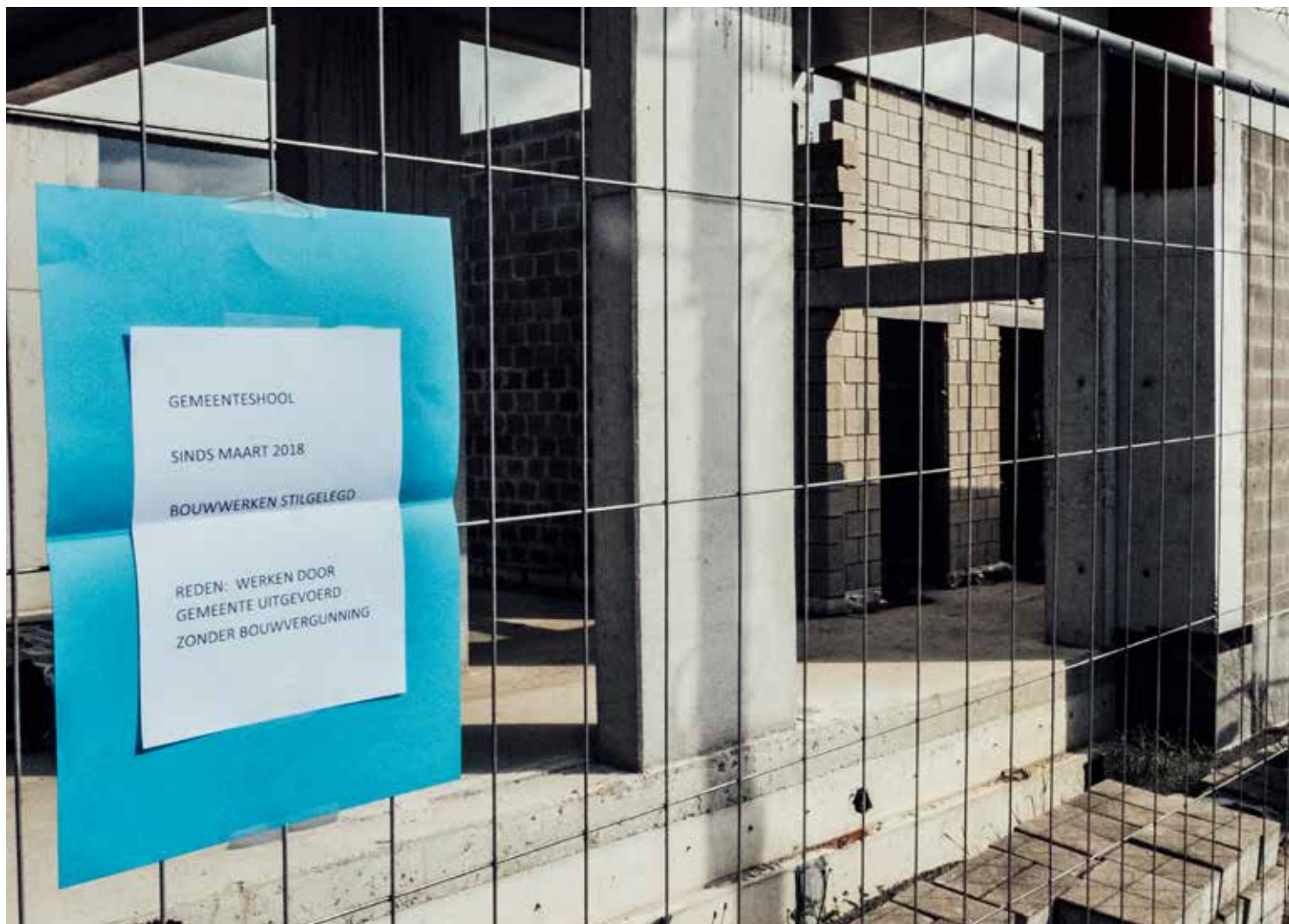
▲ Gemeenteschool : sinds maart 2018 bouwwerken stilgelegd Reden: werken door gemeente uitgevoerd zonder definitieve bouwvergunning
